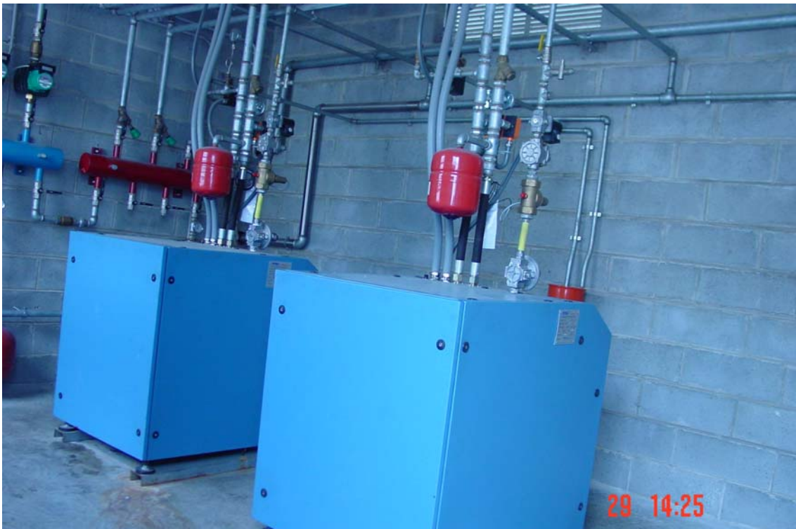
Equips generadors d'electricitat
