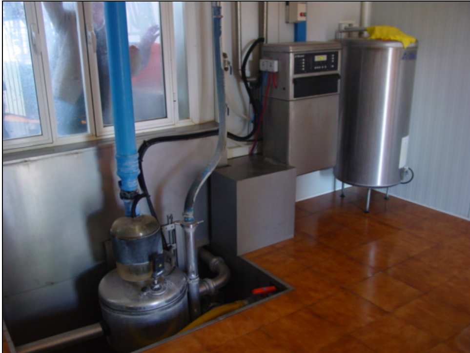
Unitat final de la sala de munyir, exterior a la sala
