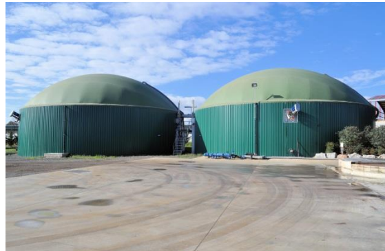
Digestors planta biogàs
